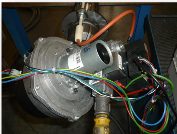
Ensemble contrôle de flamme et amenée du mélange air-gaz, monté sur brûleur.
